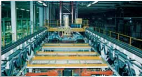
Система электропитания на автоматической линии сварки автомобилей.
